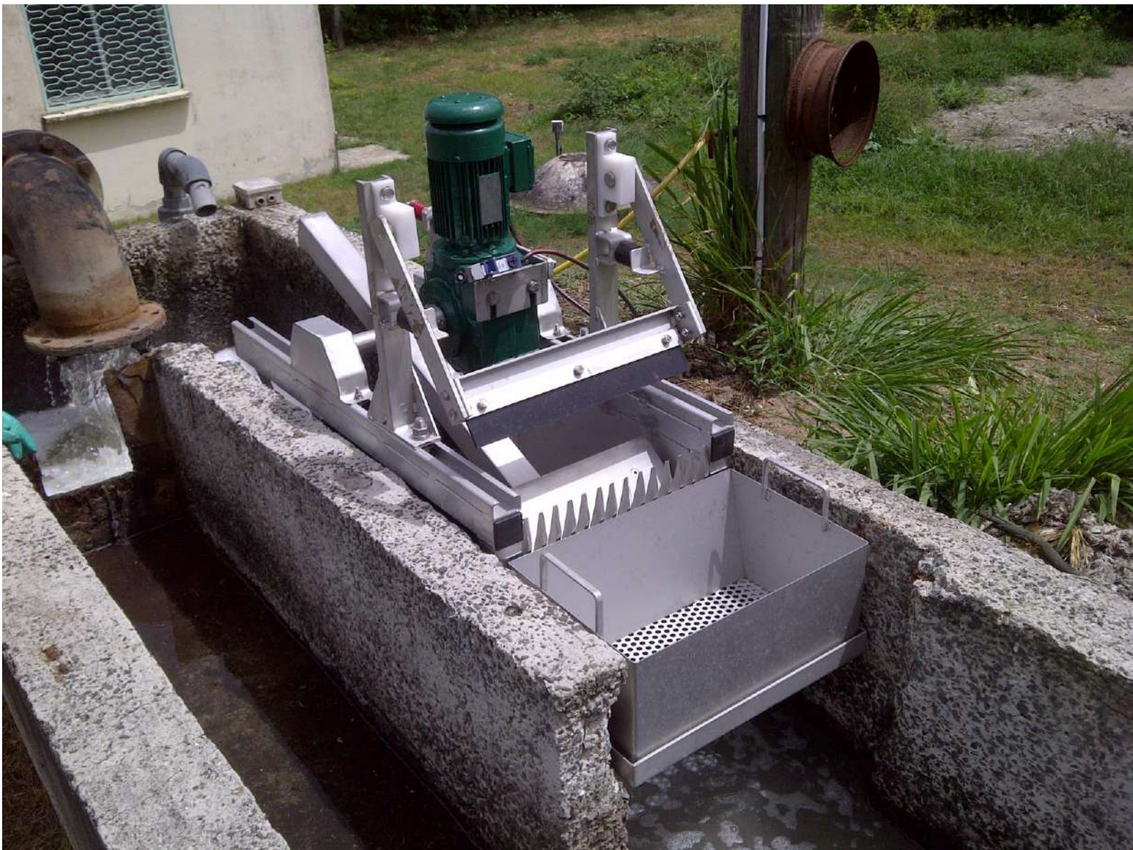
Dégrilleur STEP Folle Anse
