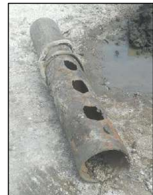
Figure : Dommages causés sur la conduite provoquant une fuite d'eau majeure
