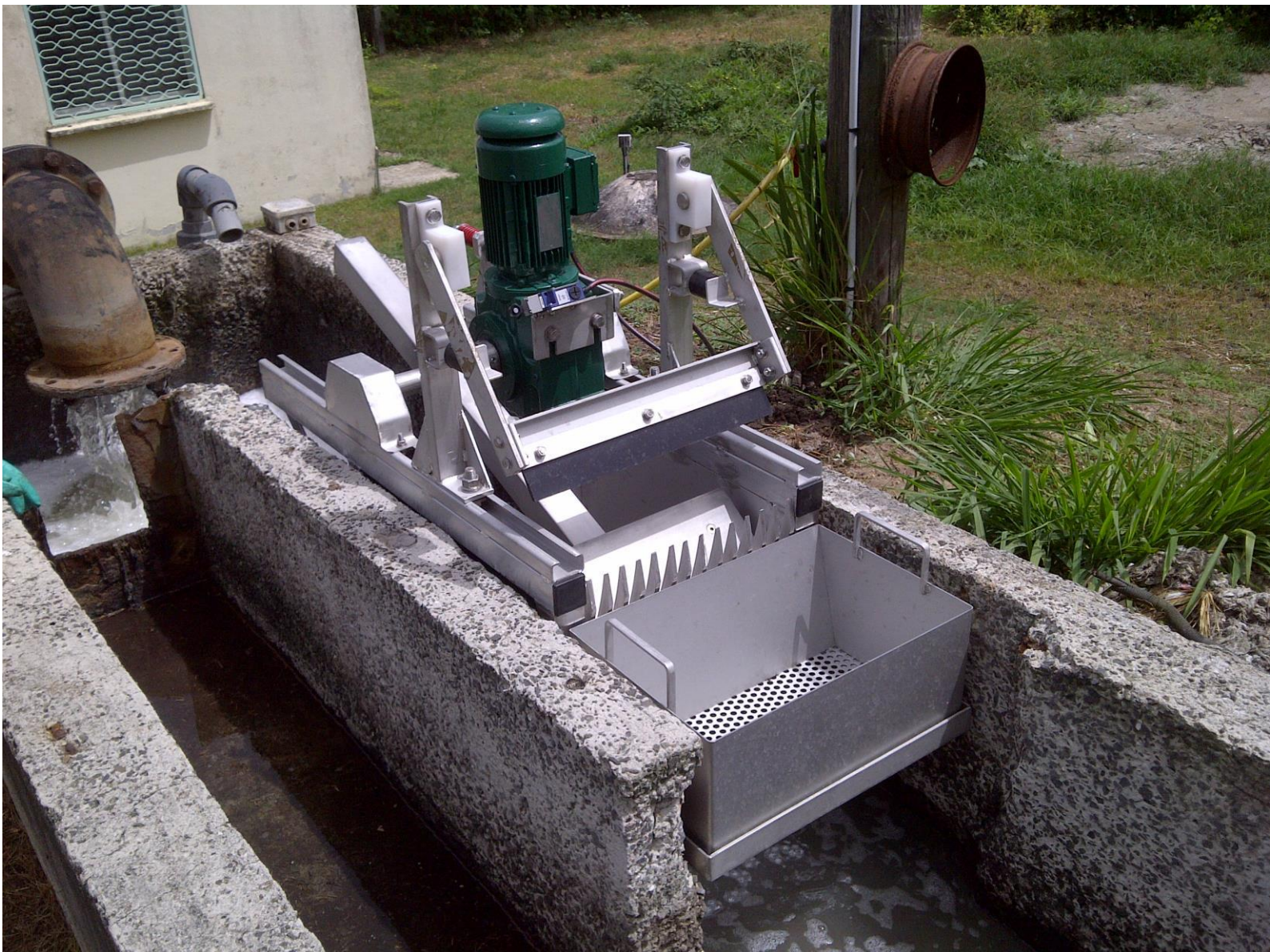
Dégrilleur STEP Folle Anse
